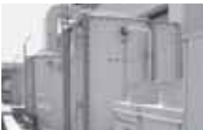
瑞穗工厂导入的冰蓄热空调系统
