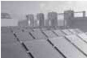
兄弟亚洲有限公司 布吉南岭兄弟亚洲制造厂职工宿舍屋顶设置的太阳能蓄热温水装置
